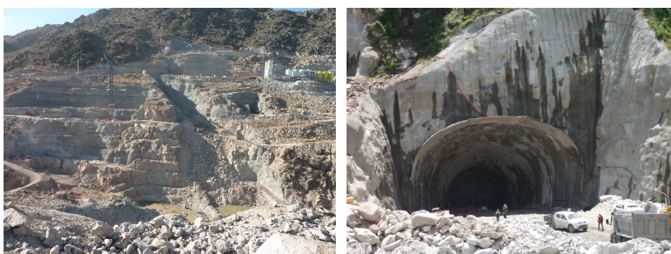
FIGURA 4. Escavação para construção de uma barragem e emboquilhamento de um túnel: todas as superfícies escavadas são cartografadas em pormenor pelo geólogo.
