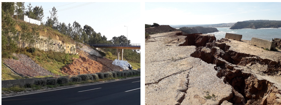
FIGURA 1. Exemplo de movimentos de terreno junto a uma autoestrada e no topo de uma arriba.
