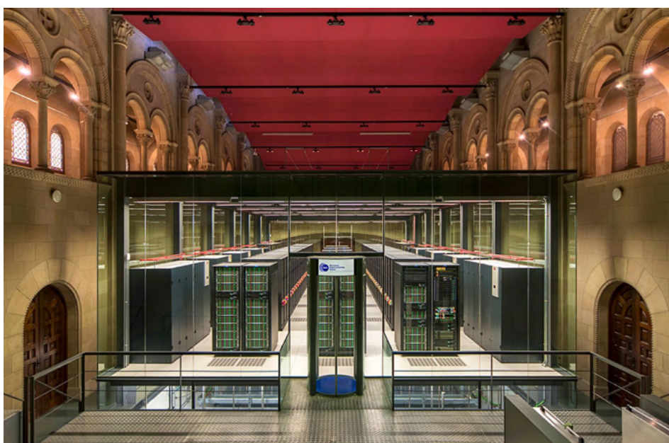
FIGURA 2. MareNostrum 4, o HPC do BSC-CNS, alojado na Torre Girona, Barcelona (Vista de dentro).
